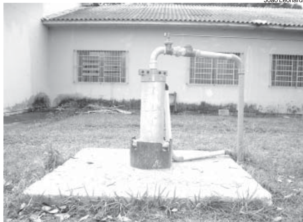
Poço tubular profundo: material utilizado no pé da obra já está se deteriorando
